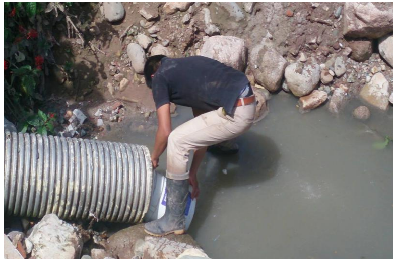
Figura 49. Punto de vertimiento, tubo PVC después de la avenida torrencial
