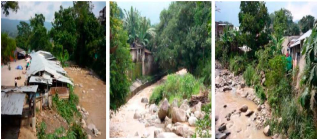
Figura 44. Construcciones sobre la ronda hídrica frente a la plaza de mercado y el muro de contención del barrio El Progreso.
