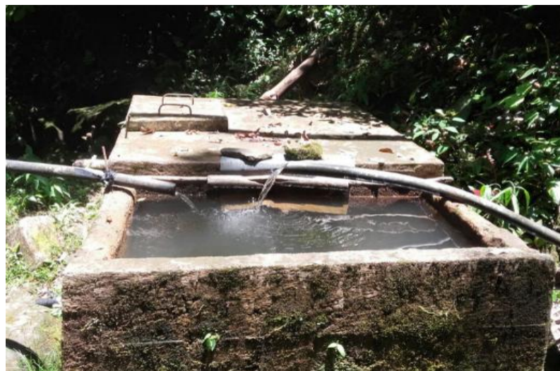
Figura 41. Tanque de almacenamiento
