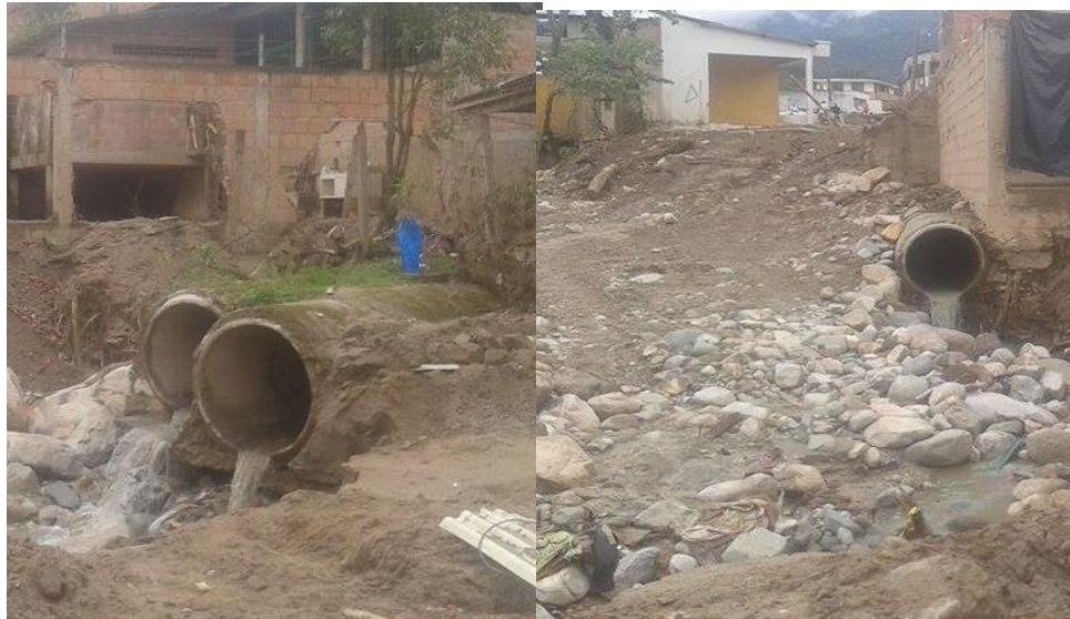
Figura 54. Punto de Vertimiento. Estación de servicios Los Bravo Después de la avenida torrencial
