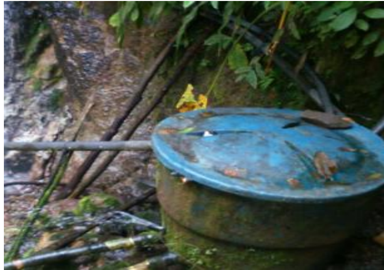
Figura 40. Tanque de captación.
