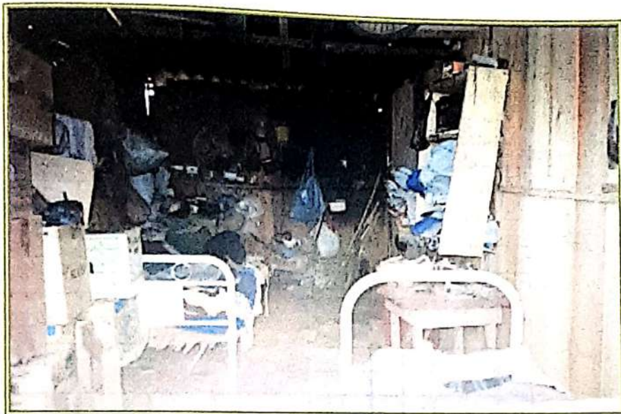
Foto 13. Microcuenca hidráulica, sector Bunge Tabanoca, presenta problemas de hacinamiento y mal estado de la vivienda.
