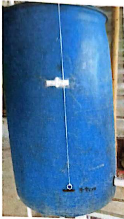
Imagen 2 Tanque de almacenamiento
