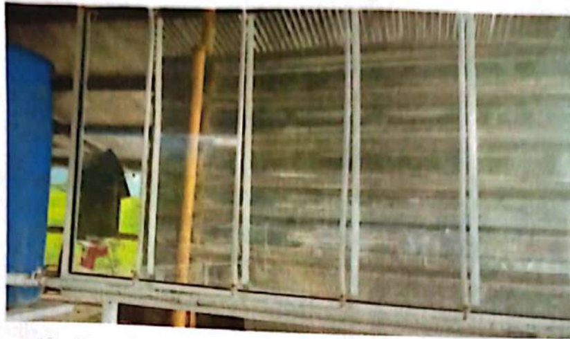
Imagen 3 Tubería de conducción
