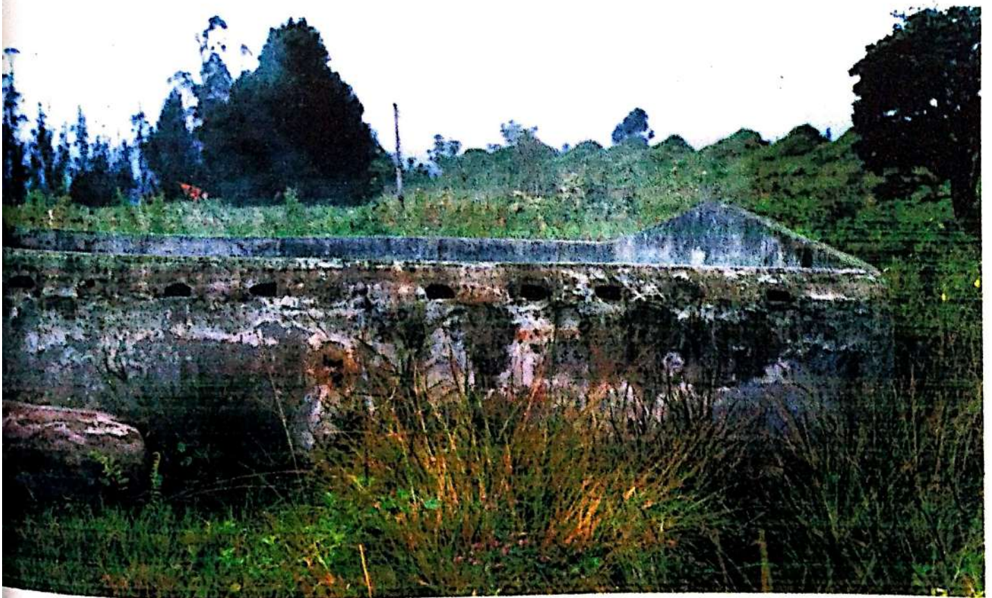
PISCINA DE AGUAS TERMALES DETERIORADA
