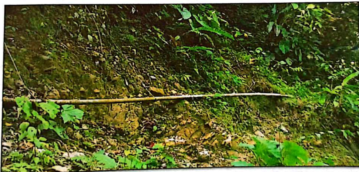
Figura 15. Tubería de Aducción Taruquita
