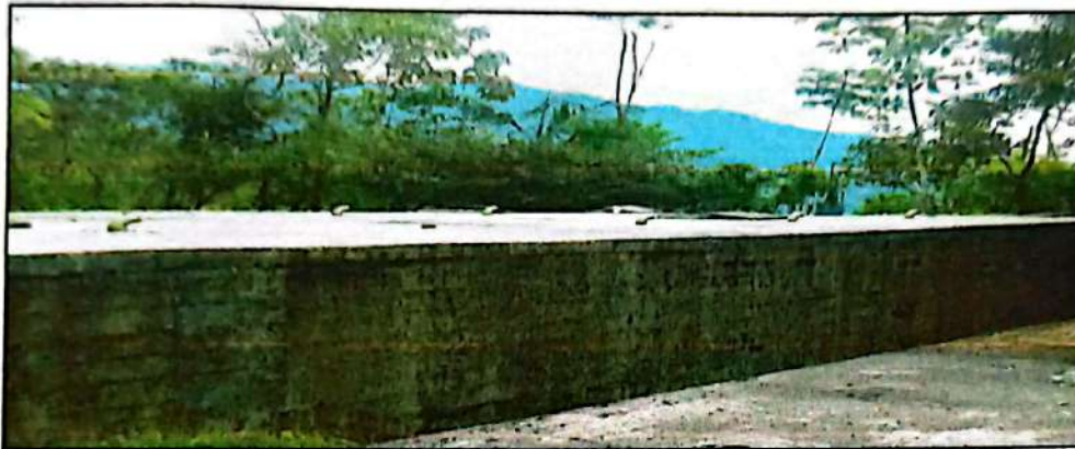
Figura 9 Tanque desarenador nuevo
