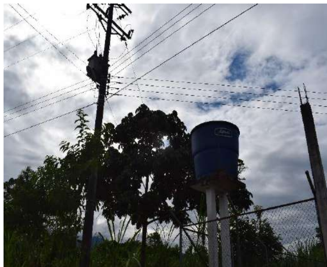
Ilustración 2 Transformador de energía y tanque de almacenamiento de agua
